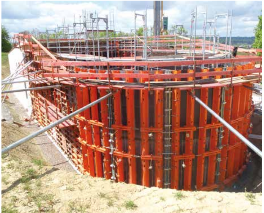
Hochbehälter, Galgenberg; Fa. Wolf & Sofsky SF Tief- und Ingenieurbau GmbH, Zweibrücken
