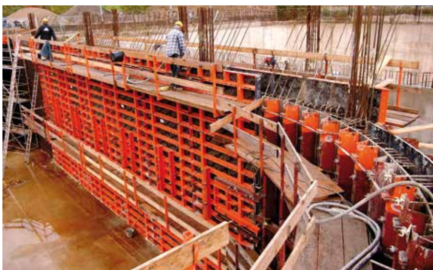
Kläranlage, L-Grevenmacher ; Fa. OBG LUX S.A., L-Ellange
