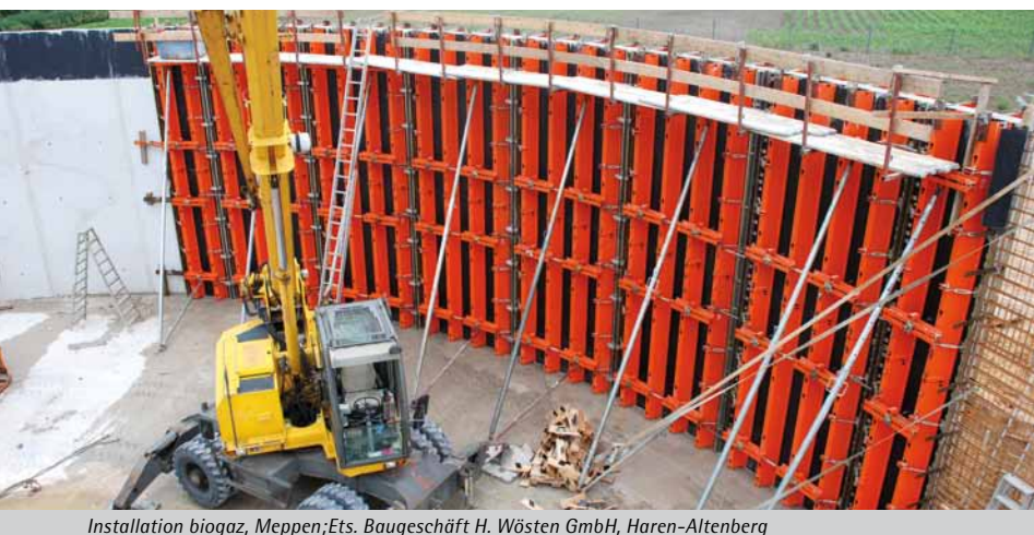
Installation biogaz, Meppen; Ets. Baugeschäft H. Wösten GmbH, Haren-Altenberg
