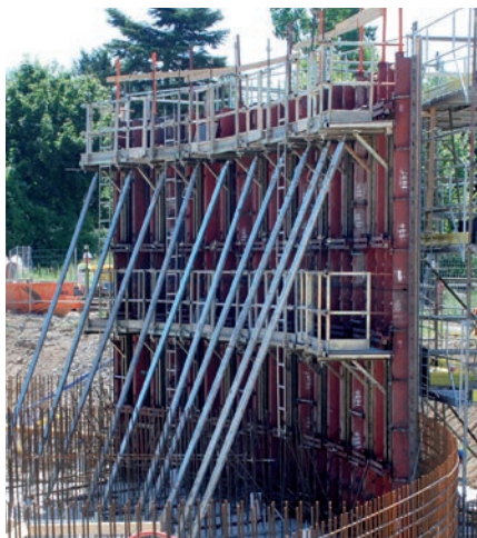
Trinkwasseraufbereitungsanlage Montry, F-Montry; Gagneraud Construction, F-Sarcelles
