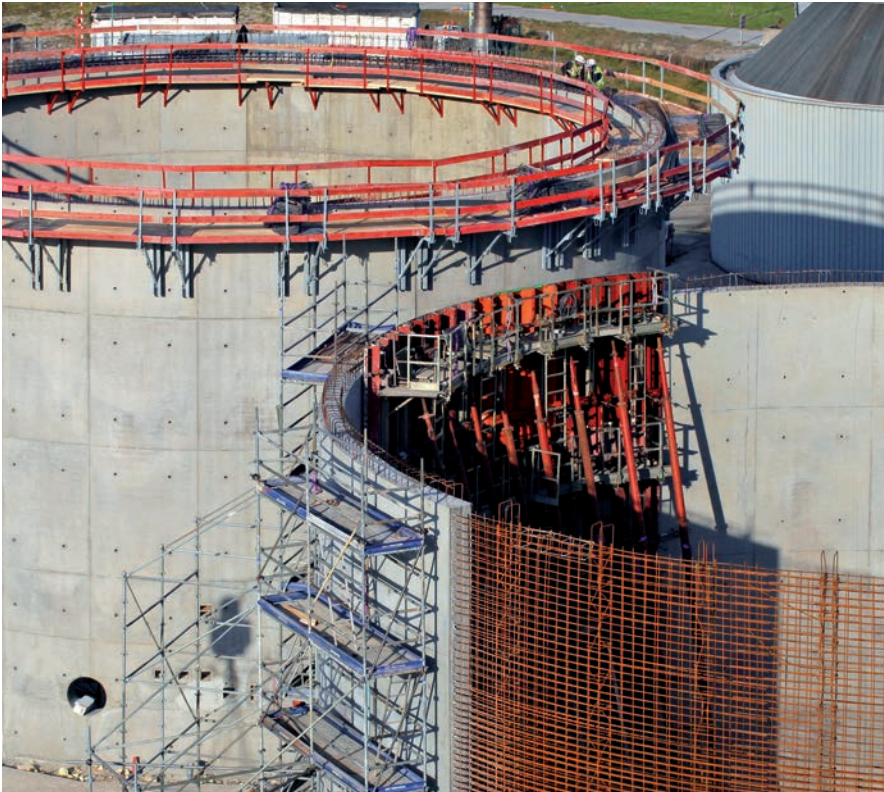
Kläranlage, F-Chambéry; Eiffage TP Agente Rhone Alpes, F-Lyon
