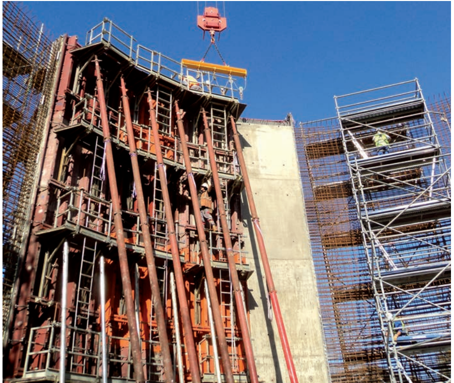
Kläranlage, F-Chambéry; Eiffage TP Agente Rhone Alpes, F-Lyon
