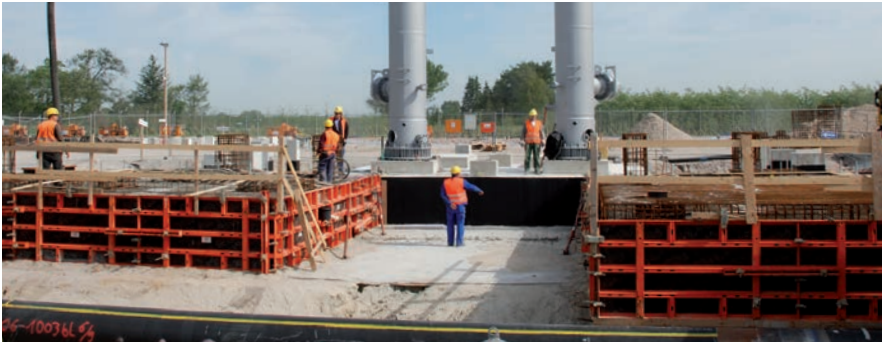
Erdgasspeicherstation, Etzel; Knoll GmbH, Haren
