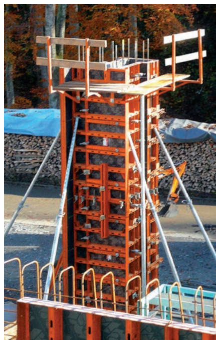
Einstellhalle, CH-Kerns; Baumeier Leitungsbau AG, CH-Luzern
