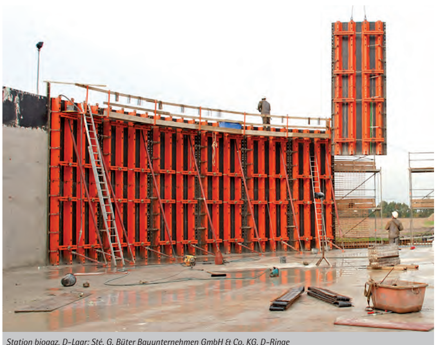
Station biogaz, D-Laar; Sté. G. Büter Bauunternehmen GmbH & Co. KG, D-Ringe
