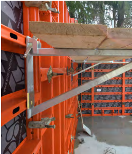
Passerelle de service
