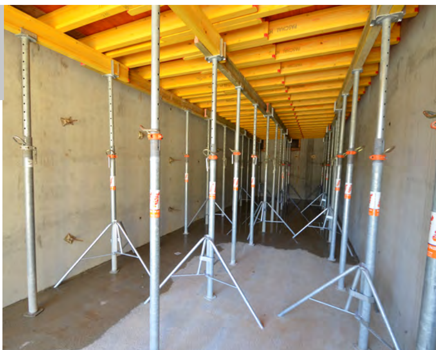
Station de sports d'hiver « Schierker-Feuerstein-Arena »; Umwelttechnik und Wasserbau GmbH & STRATIE Bau GmbH
