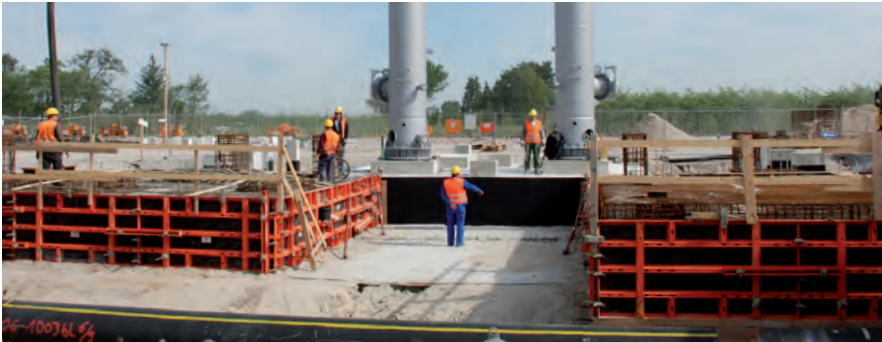
Station de stockage de gaz naturel, D-Etzel; Sté. Knoll GmbH, D-Haren
