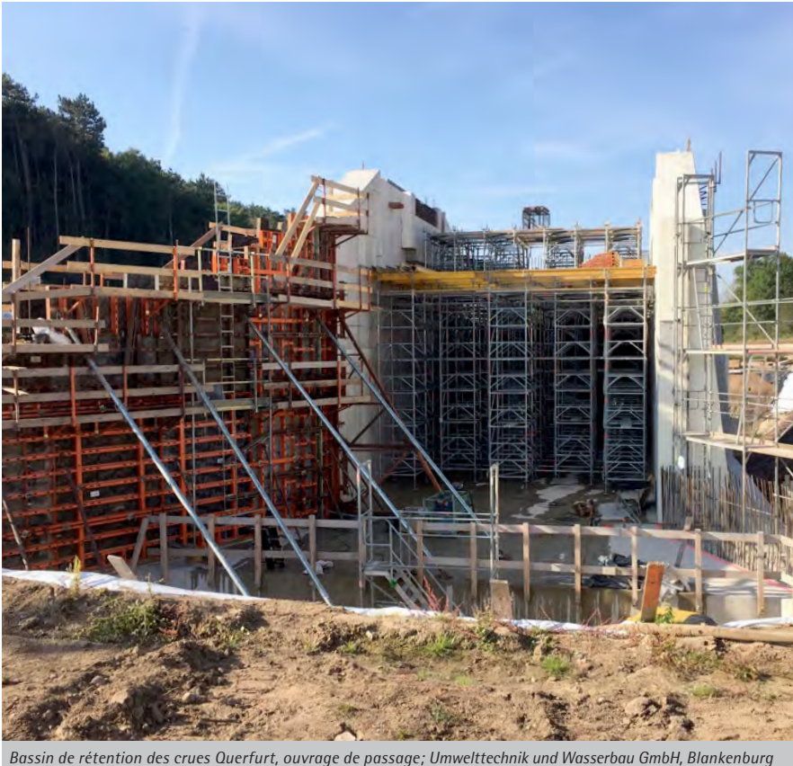
Bassin de rétention des crues Querfurt, ouvrage de passage; Umwelttechnik und Wasserbau GmbH, Blankenburg
