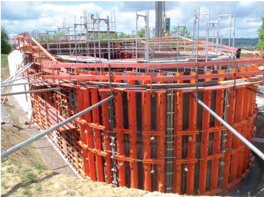
Réservoir d'eau potable aérien, Galgenberg ; Sté. Wolf & Sofsky SF Tief- und Ingenieurbau GmbH, D-Zweibrücken
