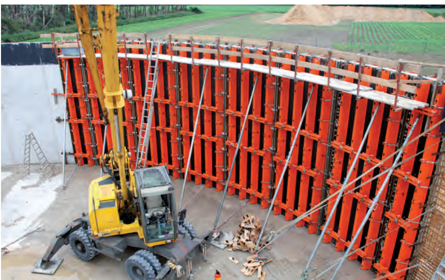
Installation biogaz, D-Meppen; Sté. Baugeschäft H. Wösten GmbH, D-Haren-Altenberg
