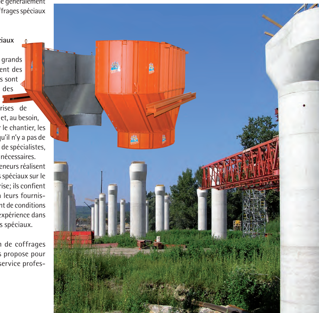
Pile de pont sur Danube Traismauer, Liaison nord RFB ; Sté. Alpine Bau GmbH, A-Vienne
