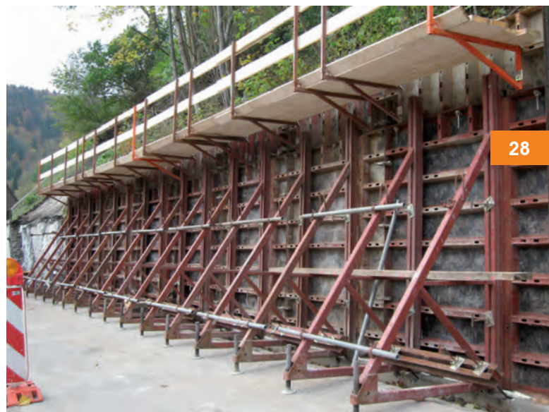
Mur de soutènement, renouvellement de la traversée de l'agglomération à Thale ; Sté. Umwelttechnik & Wasserbau GmbH, D-Blankenburg
