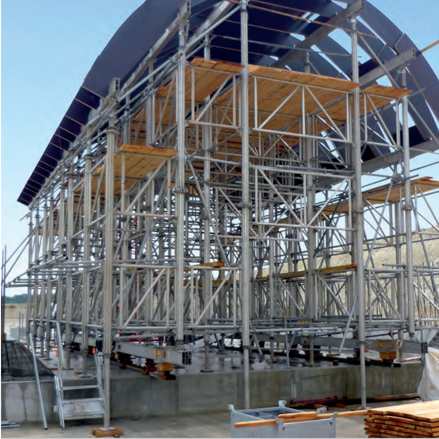
Tunnel sur voie de circulation, Construction de la LGV Tours – Bordeaux ; Sté. Vinci Construction, F-Nanterre
