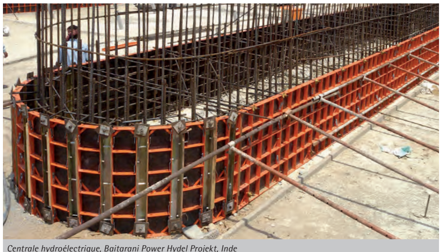
Centrale hydroélectrique, Baitarani Power Hydel Projekt, Inde
