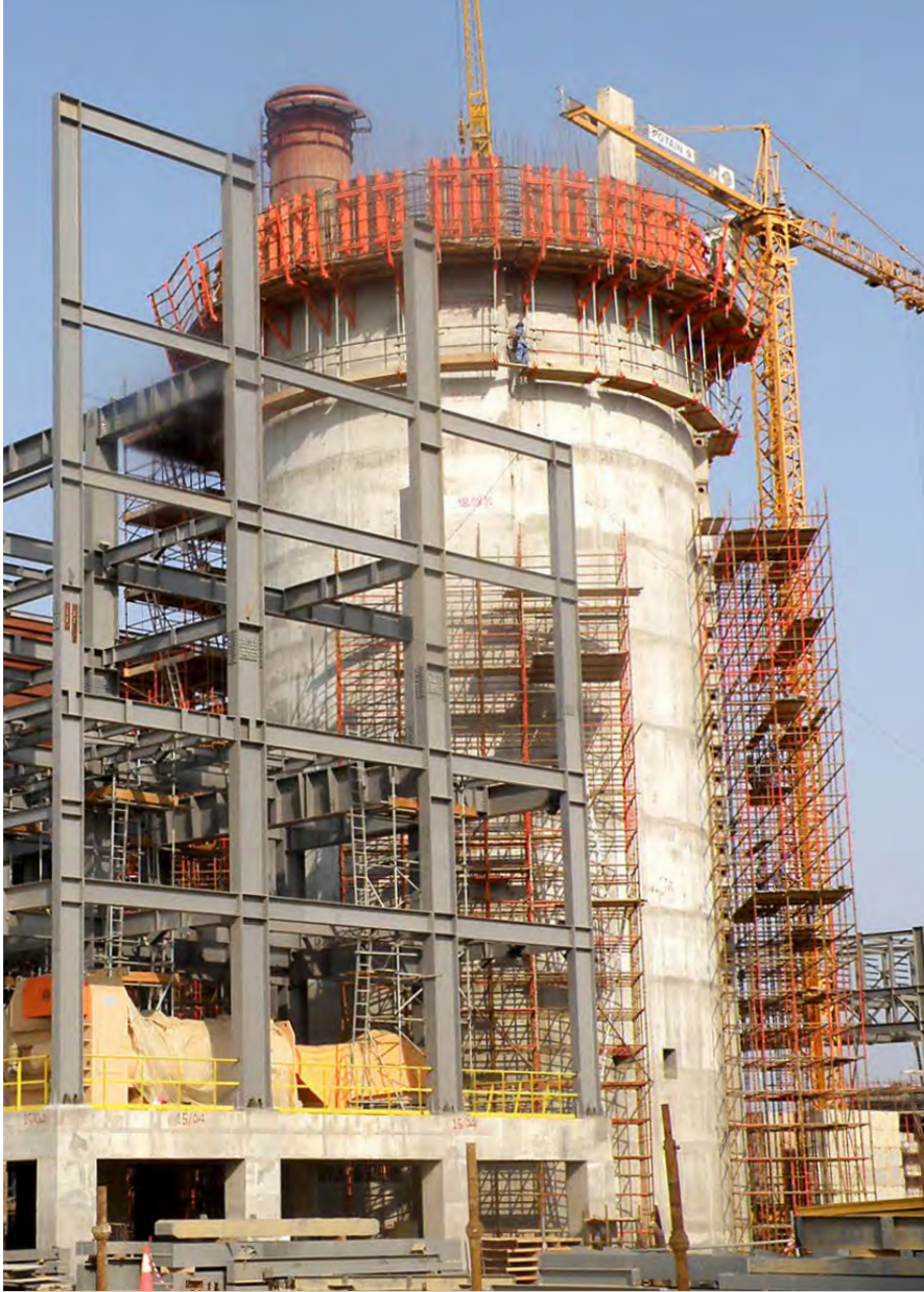
Installation de transformation de minerais, OM-Suhar ; Sté. Galfar Engineering & Contracting, OM
