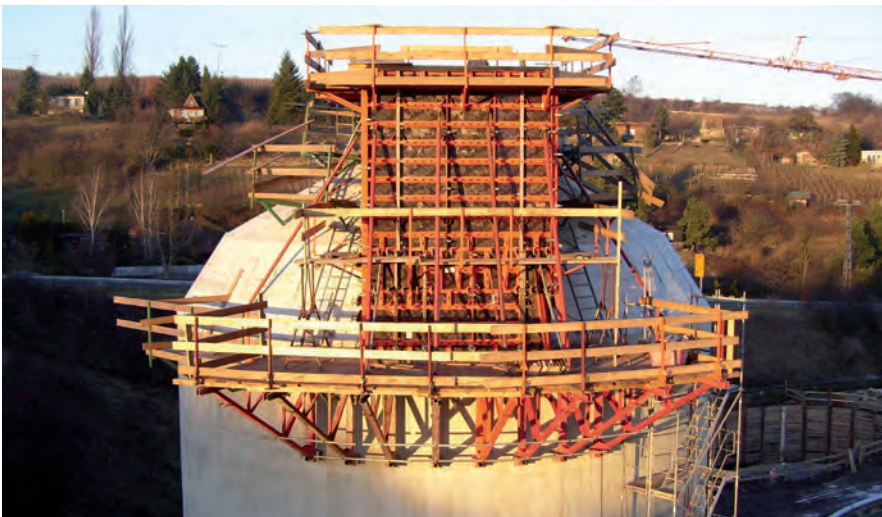
Station d'épuration - dôme d'un bassin de fermentation, D- Rollsdorf; beton & rohrbau GmbH & Co.KG, D-Halle
