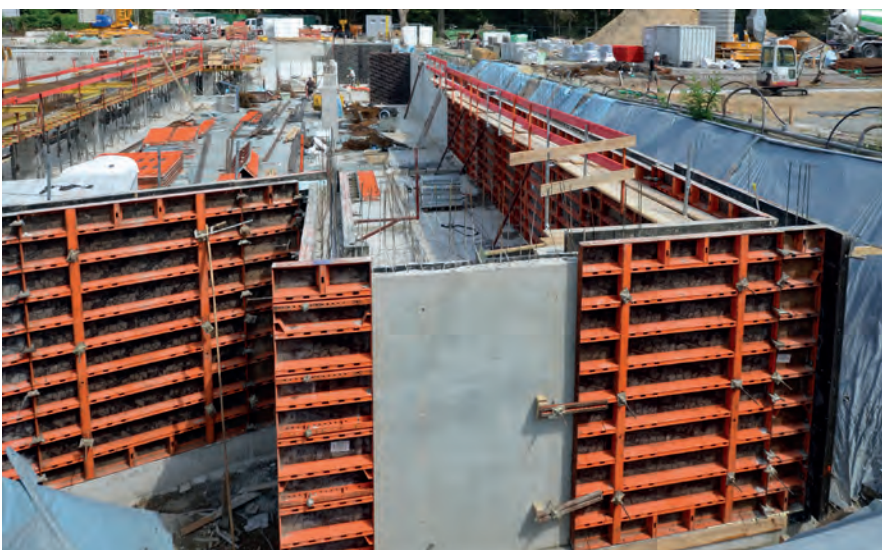
Logements et des édifices administratifs, D-Münster ; Sté. Averbeck Bau GmbH & Co. KG, D-Ostbevern
