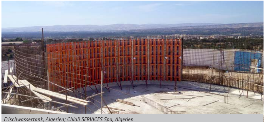
Frischwassertank, Algerien; Chiali SERVICES Spa, Algerien
