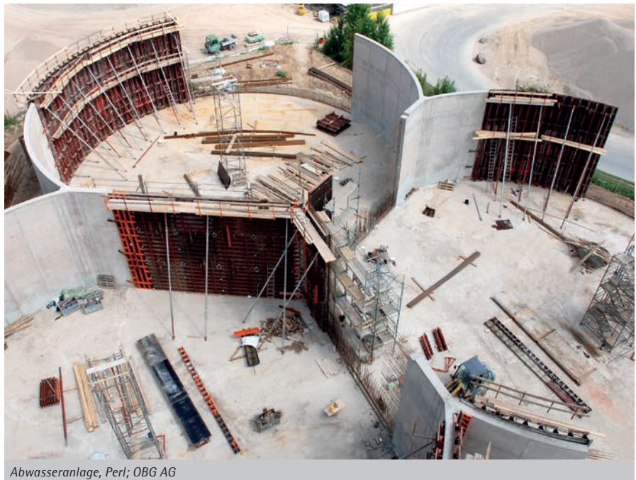
Abwasseranlage, Perl; OBG AG
