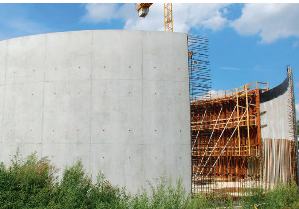
Biogasanlage, Bürstadt; Wilms, Bürstadt
