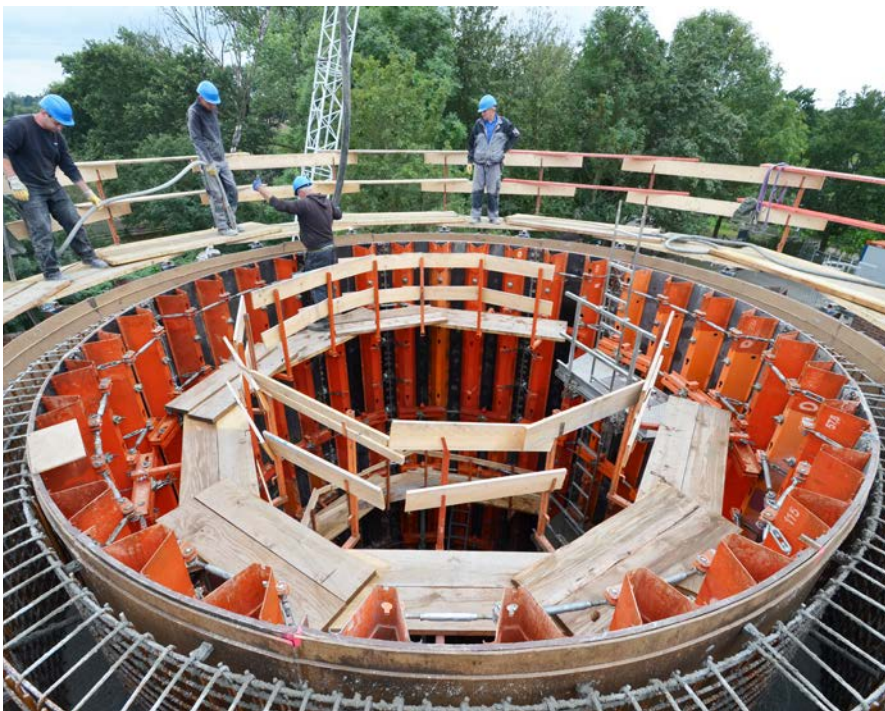
Wasserbehälter, Oberhausen; Uhrig
