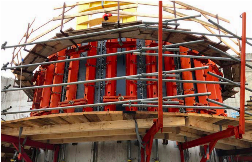
Gastro-Silo mit Panoramaplattform, CH-Einsiedeln; Föllmi AG, CH-Feusisberg
