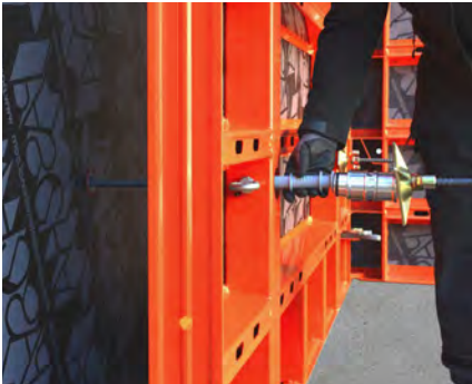
Beim einseitigen Ankeren wird der Spannstab zusammen mit dem Hüllrohr, der Wechselhülse und der Kugelgelenkplatte in die Verspanneinheit in der Stellschalung eingedreht.
